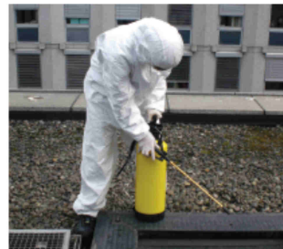
Czyszczenie wieży chłodniczej
